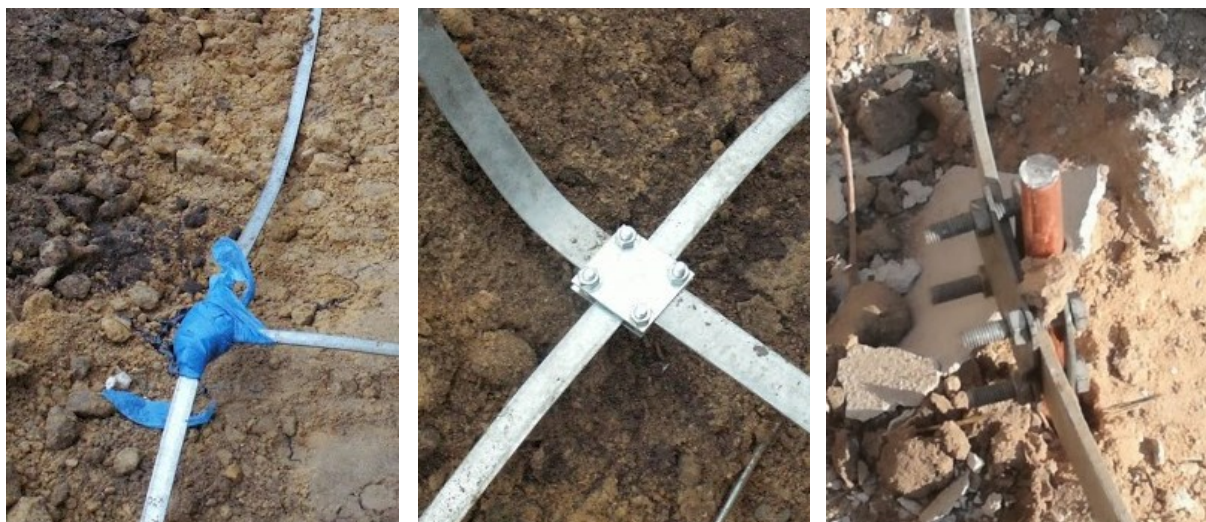
a) niewłaściwe zabezpieczenie antykorozyjne
