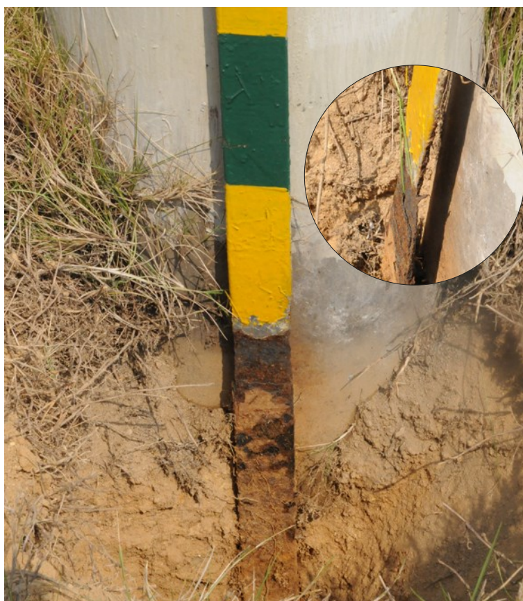
Rys. 2. Korozja cynkowanego przewodu uziemiającego StZn 40x3 mm na granicy środowisk grunt-powietrze [źródło: CBM-Technology sp. z o.o.]
