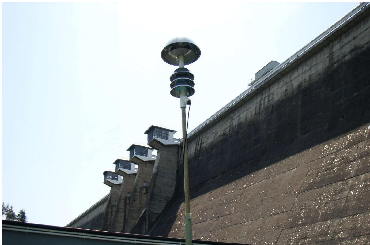
Rys. 1. Czujnik pola elektrostatycznego na obiekcie elektrowni wodnej w Solinie
