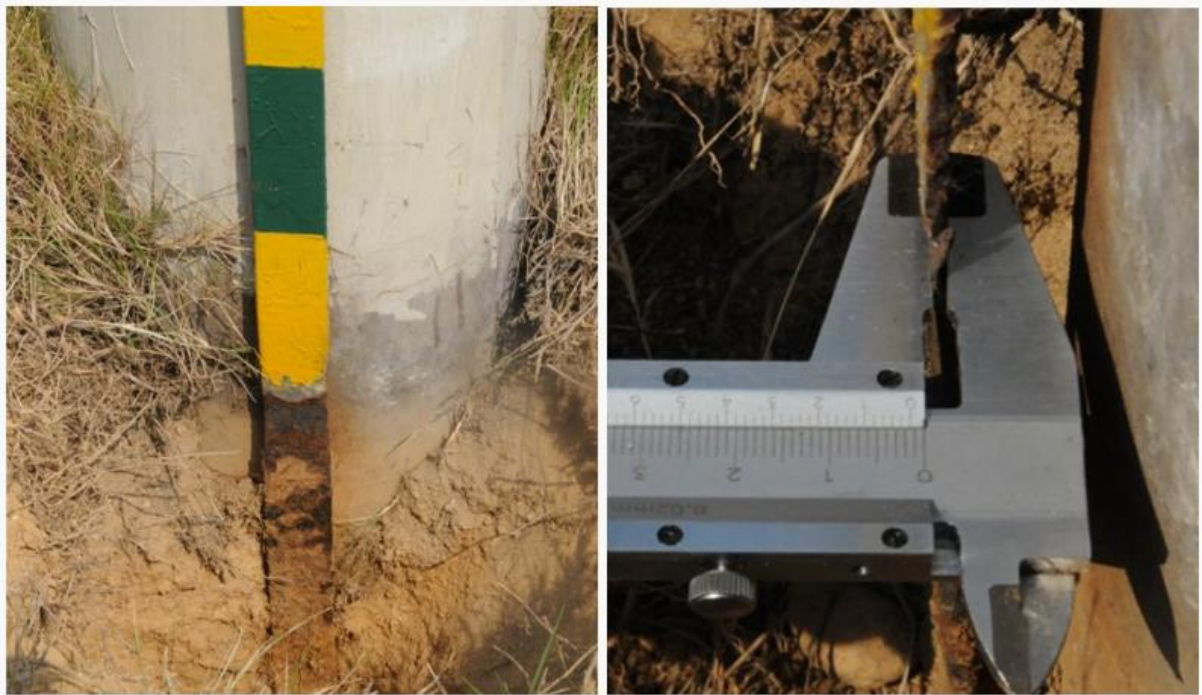
Rys. 1. Korozja przewodu uziemiającego na granicy środowisk powietrze/ziemia
