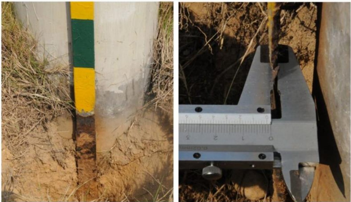
Rys. 5. Korozja przewodu uziemiającego na granicy środowisk powietrze/ziemia
