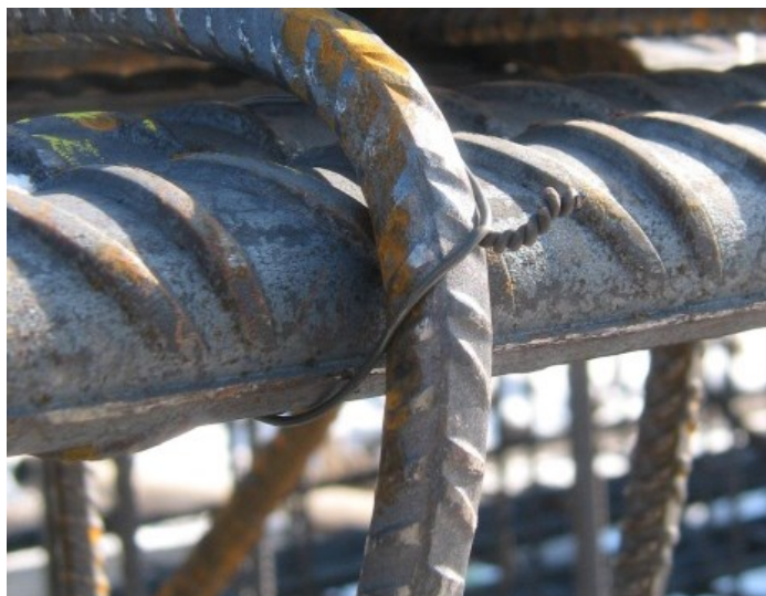
Rys. 1. Tradycyjne łączenie zbrojenia fundamentu drutem wiązałkowym nie gwarantuje pewności takiego połączenia pod względem trwałości jego właściwości elektrycznych
