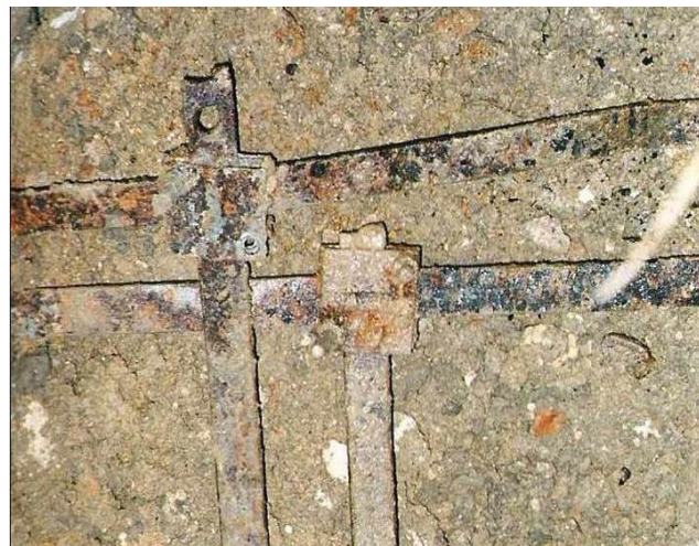
Rys. 8. Skorodowany uziom otokowy obiektu radiowo-telekomunikacyjnego po 12 latach eksploatacji (za zgodą RST sp. j.) [9]
