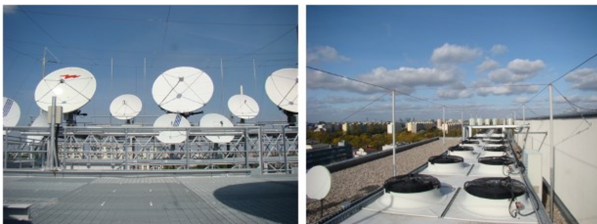
Rys. 1. Zastosowanie sieci zwodów do ochrony urządzeń elektronicznych na dachu budynku (instalacje wykonane przez RST)
