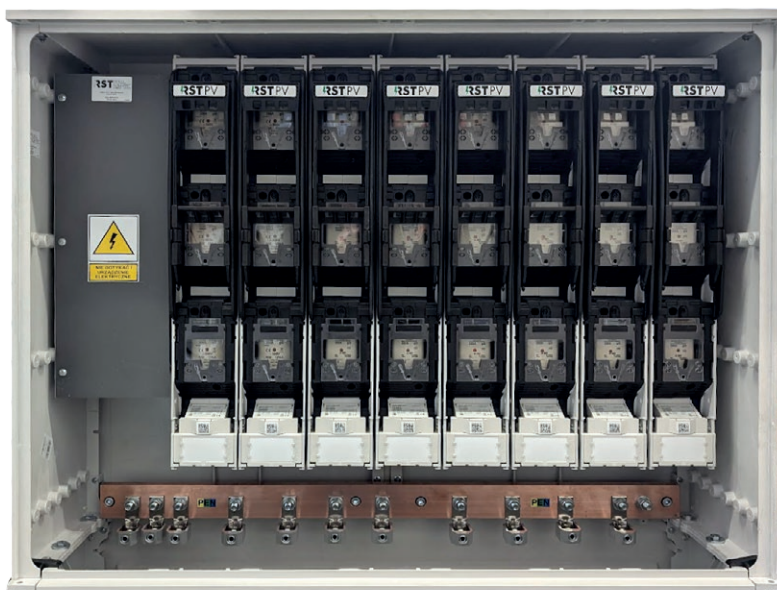
Rozdzielnica zbiorcza AC-0-ZK-800V
